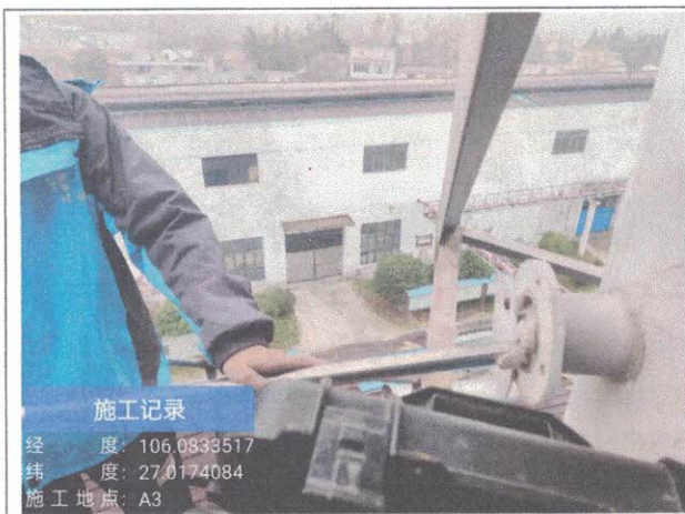
3#排气筒出口 (A3)
