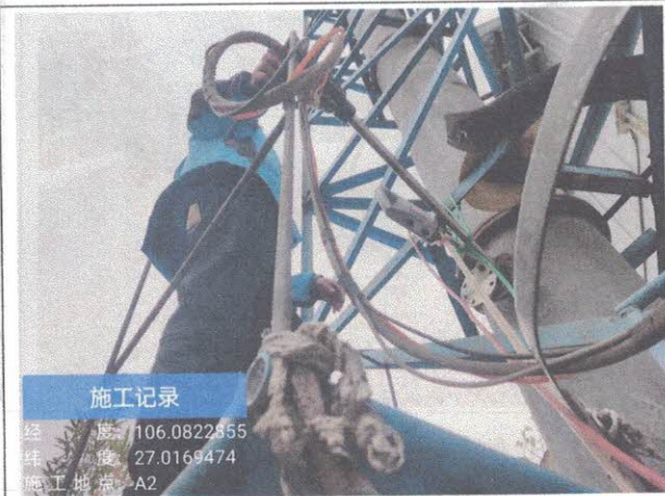
2#排气筒出口 (A2)
